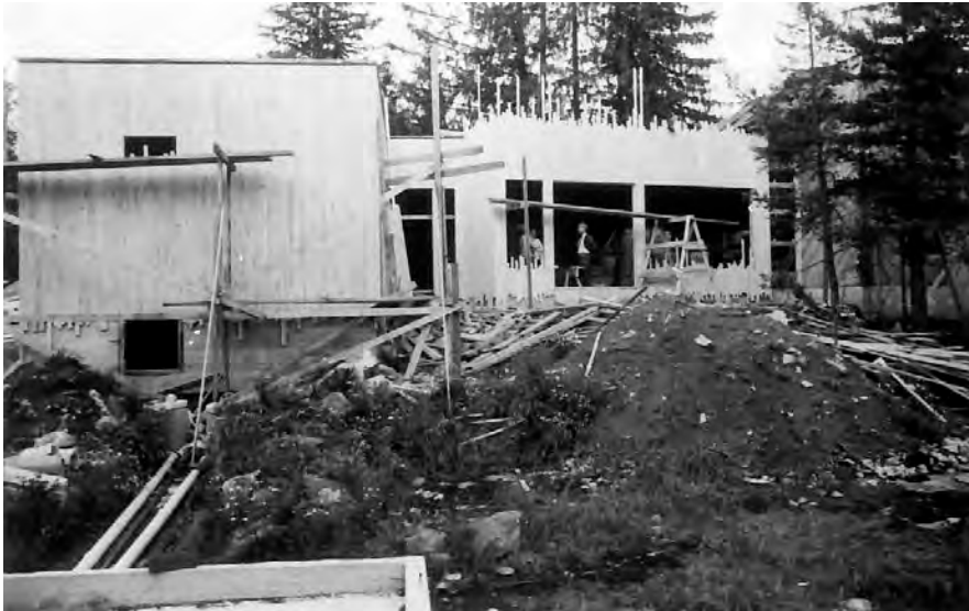
Kuva 99: Villa Kokkosen länsijulkisivu harjannostajaisten aikaan.. Olohuoneen vuoraus edelleen kesken, savupiiput eivät nousseet vesikatolle asti. Kuva: Joonas Kokkosen perikunnan arkisto, AAS AR 75-10
