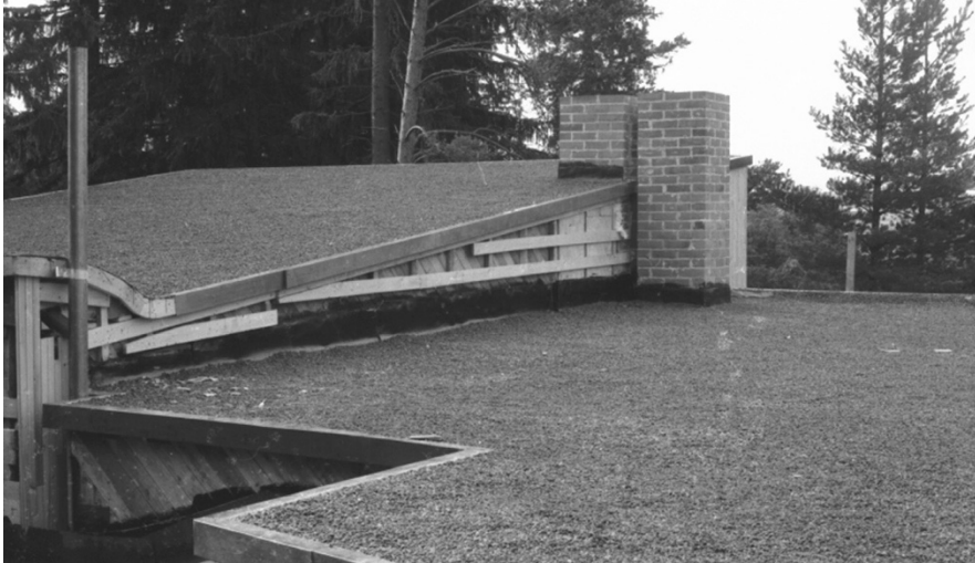
Kuva 101: Edessä olohuoneen tasakatto, taempana työhuoneen pulpettikatto, huopien päällä singelikerros. Piiput muurattu lakikorkeuteensa. Kuva: Aulis Riikonen, AAS 103267
