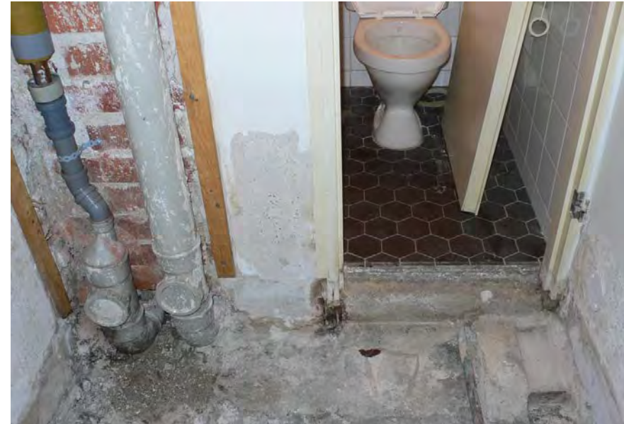
Kuva 115: Vessan viereisen kotelo vuotanut sadevesiviemäri liitännöineen vaatehuoneeseen. Kattorakenteet purettiin. Kuva: Käpy Paavilainen
