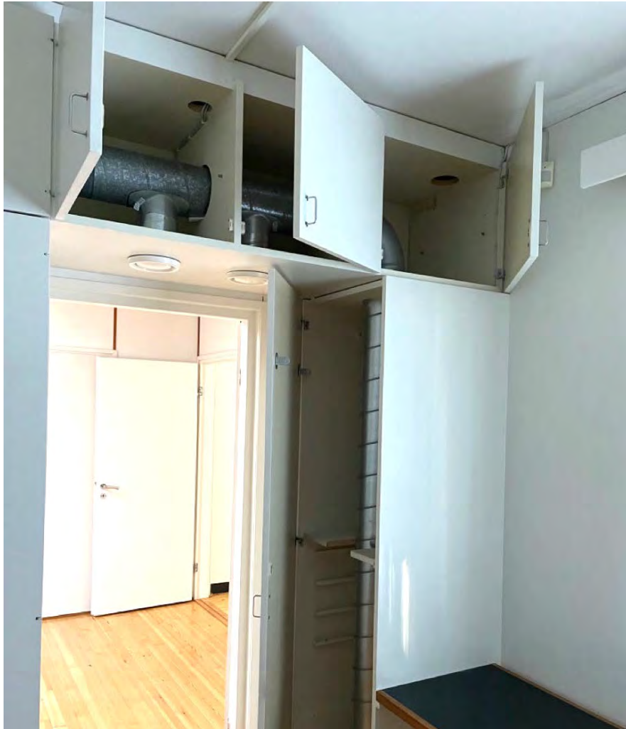
Kuva 119: Nykyisen pienen kokoushuoneen, entisen vanhempien makuuhuoneen, kiintokaapistoon pilotettuja IV-kanavistoja sekä poistoilmaelimä. Kuva: Joni Rousku / AAS
