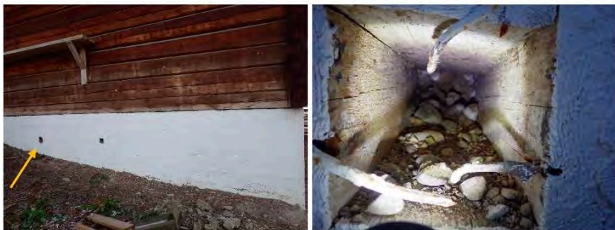
Kuva 22. a. Saunan sokkelissa on pohjoisjulkisivussa kaksi aukkoa. Vasen (nuoli) on havaintojen mukaan saunan korvausilmareitti ja oikea (kuva b) johtaa saunakamarin alapohjan alustatilaan. b. Saunakamarin alapohjan alustatilassa on soraa ja kiviä. Alustatilaan oli kaksi tällaista aukkoa, toinen pohjois- ja toinen länsisivun sokkelissa.
