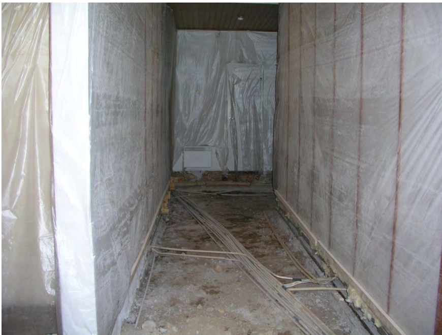
Kuva 117: Käytävästä purettu lattiarakenteet kosteusvaurioiden ja IV-kanaviston tieltä. Seinäpinnat suojamuovitettu. Kuva: Käpy Paavilainen
