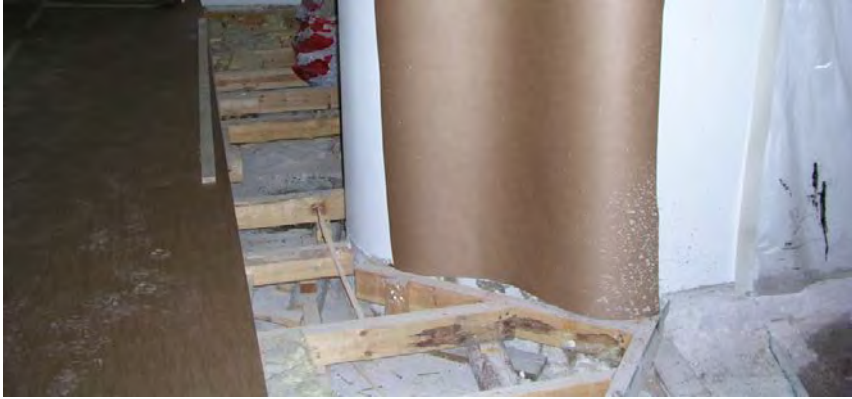
Kuva 122: Valokuva olohuoneesta vaatehoidon vastaiselta seinältä v. 2005. Kattovuodon kas- telemat eristeet poistettu ja koolausrakenne selvästi näkyvissä. Kuva: Käpy Paavilainen.
